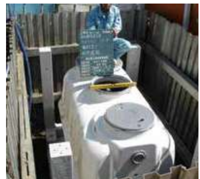
浄化槽レベル確認
