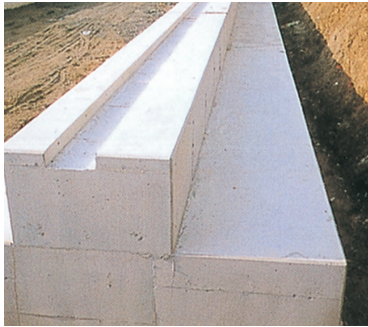
■現場打ちで施工し、特に基礎のキーウェイは注意して打設を行います。
