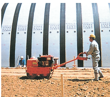
■盛土工は坑口付近の盛土工と同時期に行われるため相互に調整して施工を行います。
