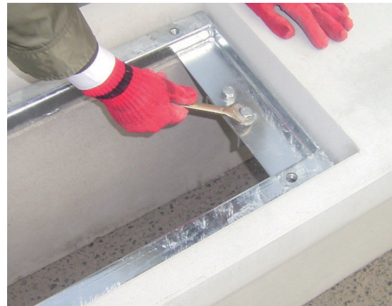
4. 側溝本体と受枠が一体となるようにボルト締めを行います。
